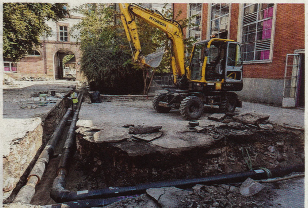
Côté chauffage, au terme de toute une réflexion autour du développement durable, il a été décidé de raccorder la Manufacture au réseau de chauffage urbain de l'Esplanade, alimenté par la centrale biomasse. PHOTOS DNA - CEDRIC JOUBERT
